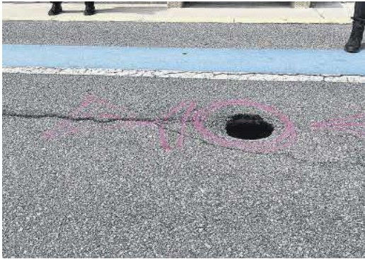
El nuevo agujero abierto en la calzada del vial. | S.Á.
