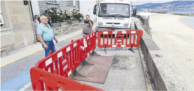
El Concello tapó con una plancha metálica y valló el agujero en el vial de O Con. | Santos Álvarez
