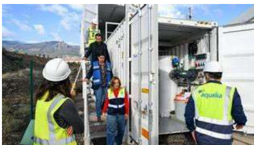
La nueva desaladora del Valle de Güímar triplica la producción de agua
